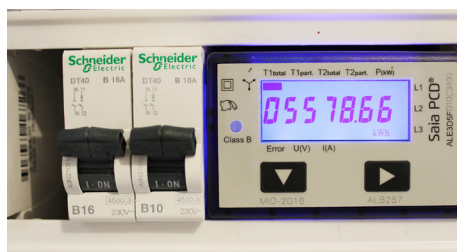
Un compteur mesure à chaque instant la production photovoltaïque.
